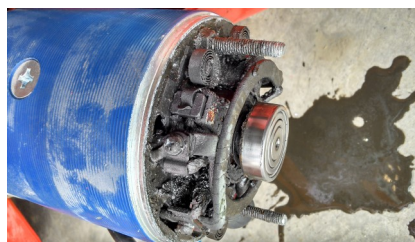
Wasserschaden an Antriebsmotor
