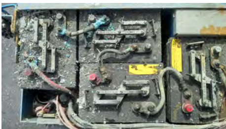
Defekte Batterien ersetzen
